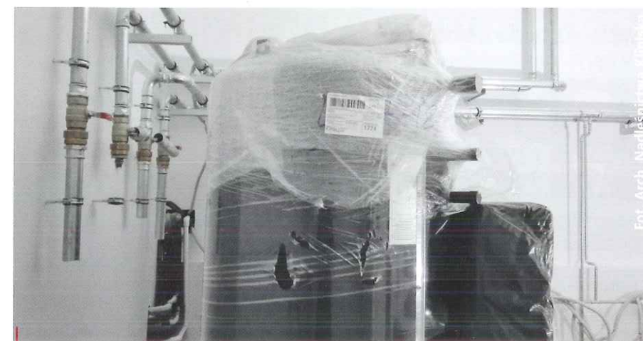
Fabrycznie zapakowana pompa ciepła zasilana z ogniw fotowoltaicznych zakupiona przez Nadleśnictwo Kliniska
